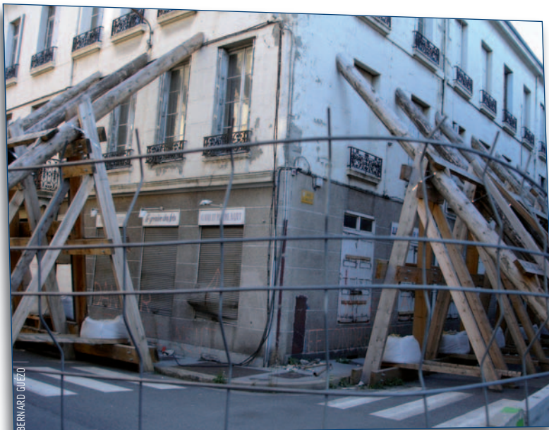
Étaieage d'un immeuble menaçant péril, à Saint-Étienne (Loire).
