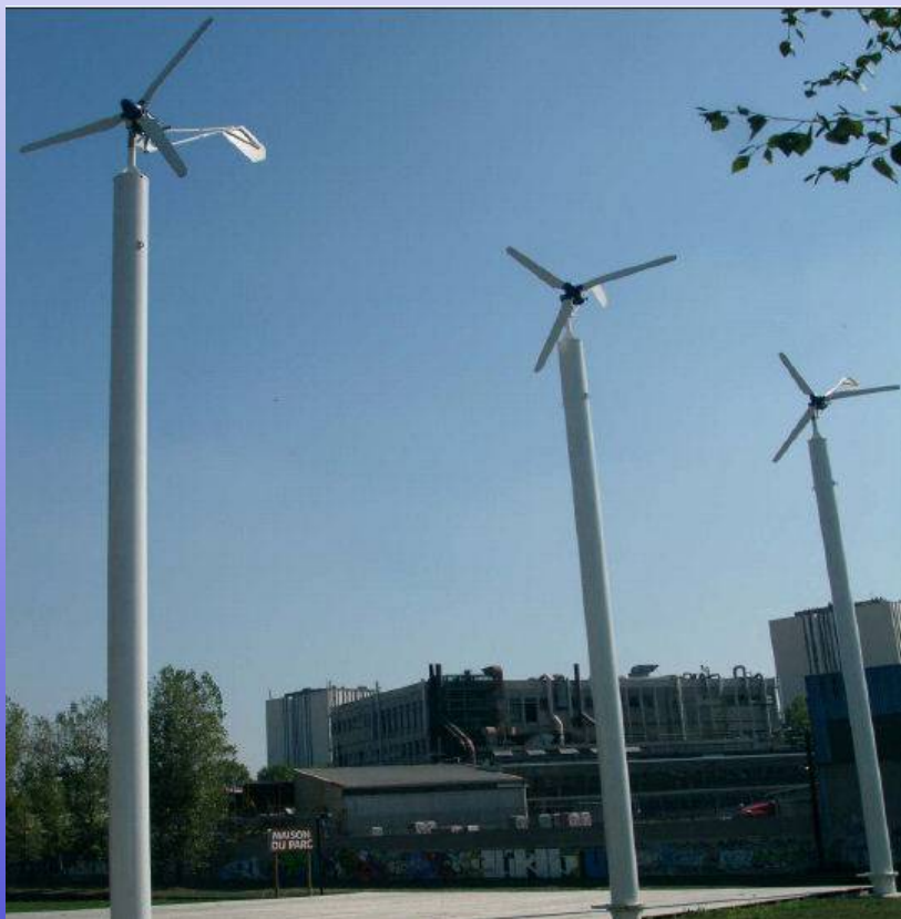
Maison d'accueil de Bobigny: 3 éoliennes de 6kW
